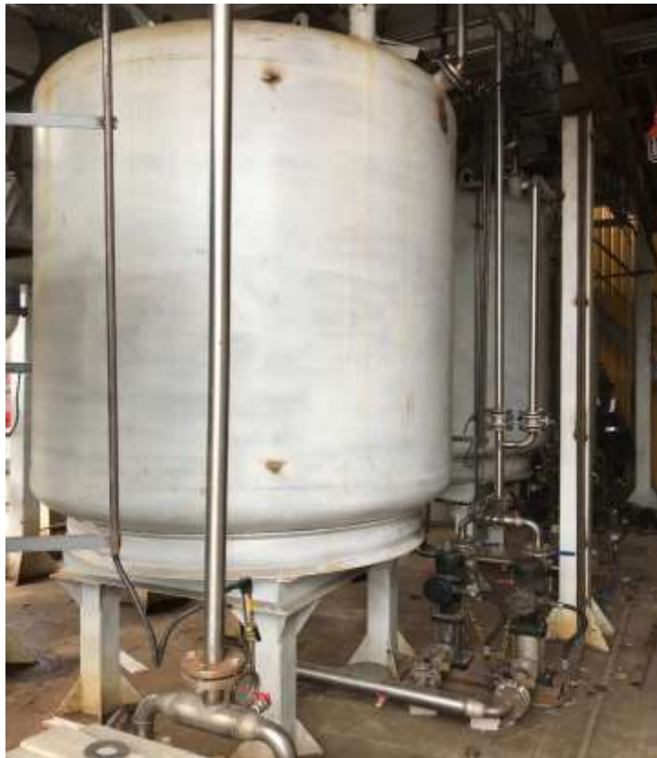
Рис. 2.7. Дослідно-промислова установка з об'ємом реактора 2 м 3
